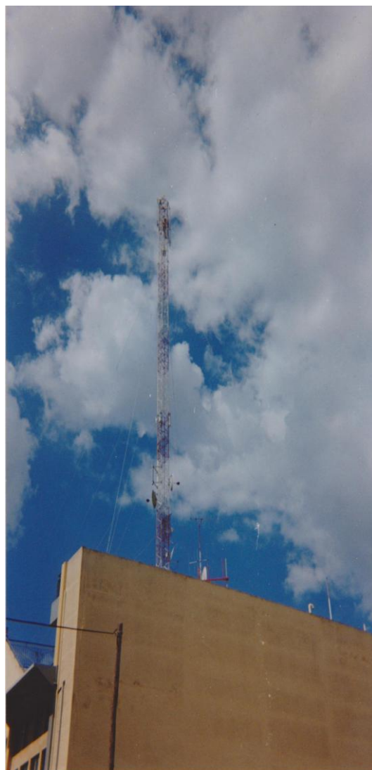
Η κεραία του σταθμού στο Ραδιοφωνικό σταθμό της Οδού Αγ. Τρύφωνος
